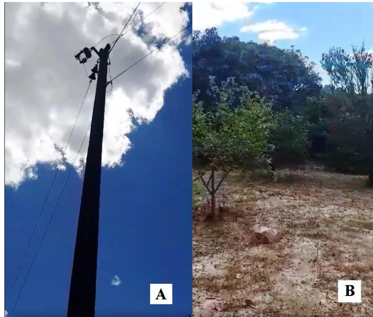
Figura 2. Fotos da área do acidente. A – Disjuntor aonde foi eletrocutado o indivíduo. B – Arredores do poste com o disjuntor.
