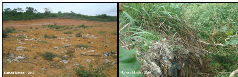
Figura 2. Área central do lixão após aterramento com resíduos superficialmente expostos (esquerda) e afloramento de resíduos no talude (direita).
